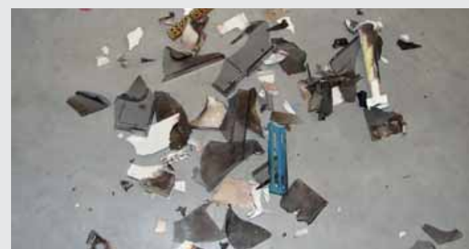
Rys. 8 Uszkodzona rozdzielnica niskiego napięcia z ogranicznikiem „B+C” po przepływie prądu 100 kA, 10/350µs
