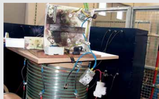
Rys. 10 Uszkodzona rozdzielnica niskiego napięcia z ogranicznikiem „B+C” po przepływie znamionowego prądu impulsowego (Iimp)
