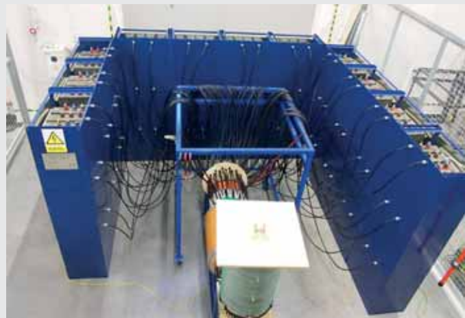
Rys. 3 Generator udarów prądowych:
