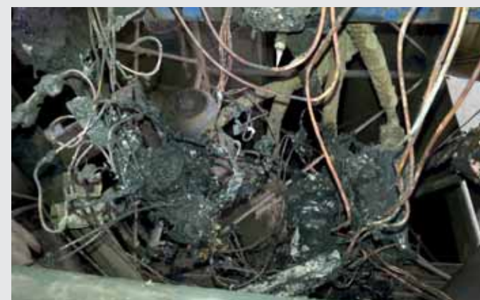
Rys. 7 Pożar spowodowany eksplozją ogranicznika przepięć
